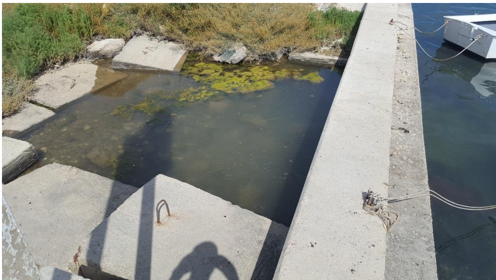
Slika 3. – Jama u zaobalnom dijelu postojeće šetnice
